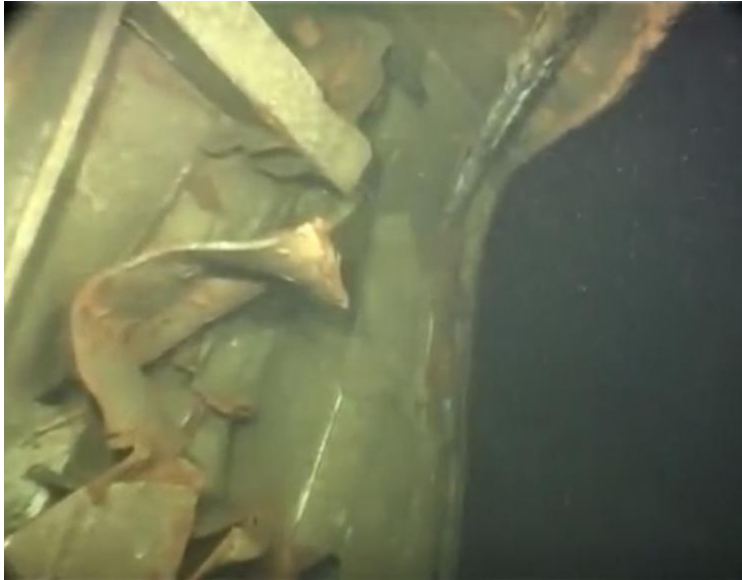
Rampens styrbords nedre hörn år 2000 med en mycket kraftig skada av sidobalken.
